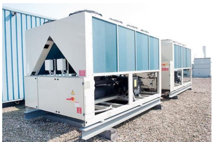
Groupes frigorifiques avec condenseurs
